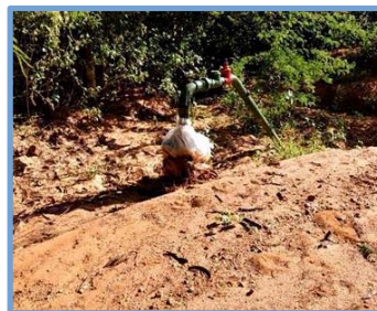
Figura 3-3- Captação no poço 01 da ETA Umburanas
