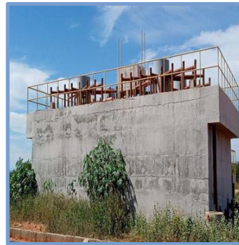
Figura 3-8- Reator UASB da ETE Ourolândia
