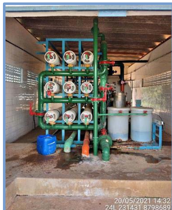
Figura 3-6- Módulos de dessalinização da ETA Umburanas
